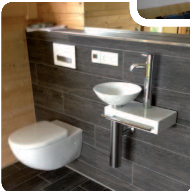
Blockhaus-Gästebad mit WC, Waschbecken und Duschkabine.
